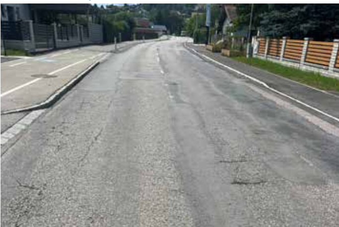
Massive Schäden am Fahrbahnbelag
